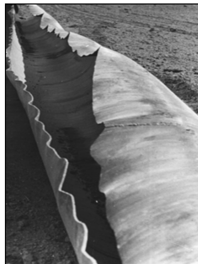
Рис.1. Протяженное разрушение трубопровода
